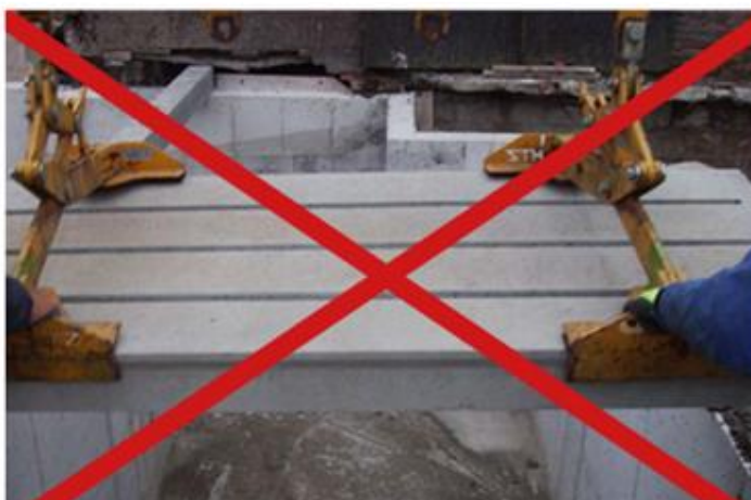
Foto 6: De betonnen stalvloeren van het emissiearme roostervloer type G3 dienen met een roosterklem gelegd te worden (klemmen op de kopse zijde), of met vier rooster-T-haken. De elementen mogen NOOIT dwars geklemd worden.
